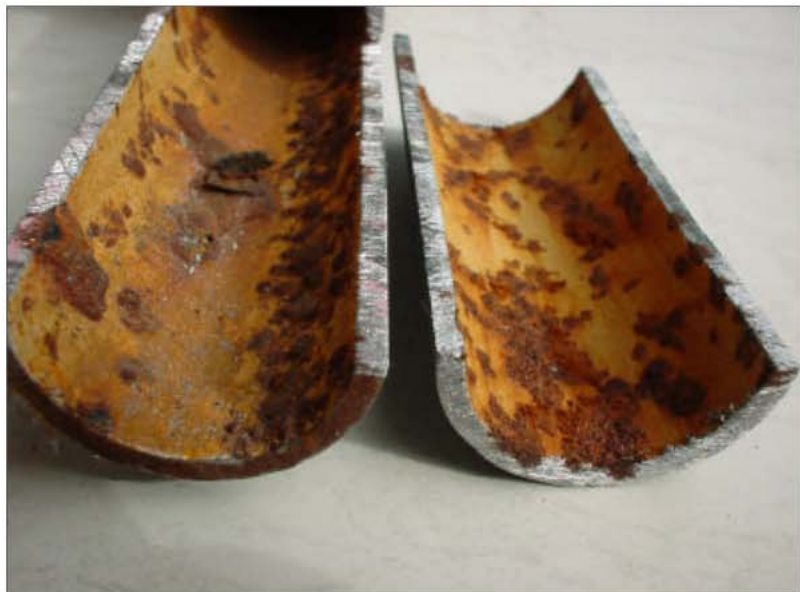
Abb. 1: Innen verrostete Rohre (Quelle: Tanner Wasseraufbereitung, Reigoldswil)
